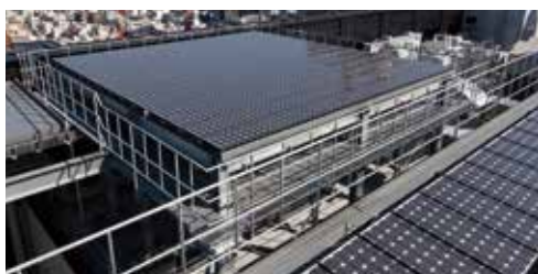
駿河台新館屋上に設置した太陽光パネル
